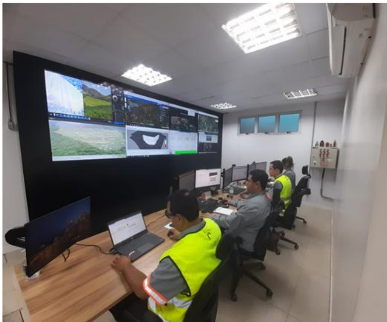
Imagem 7.1 – Centro de Monitoramento Geotécnico da Barragem Serra Azul.
